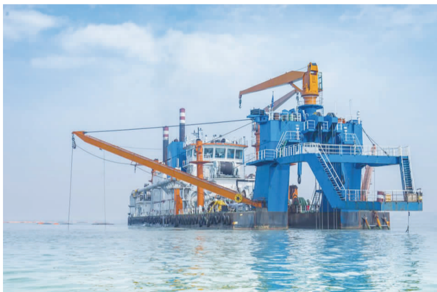
图为绞吸船在小庙洪上延航道工程(一阶段)进行疏浚作业
